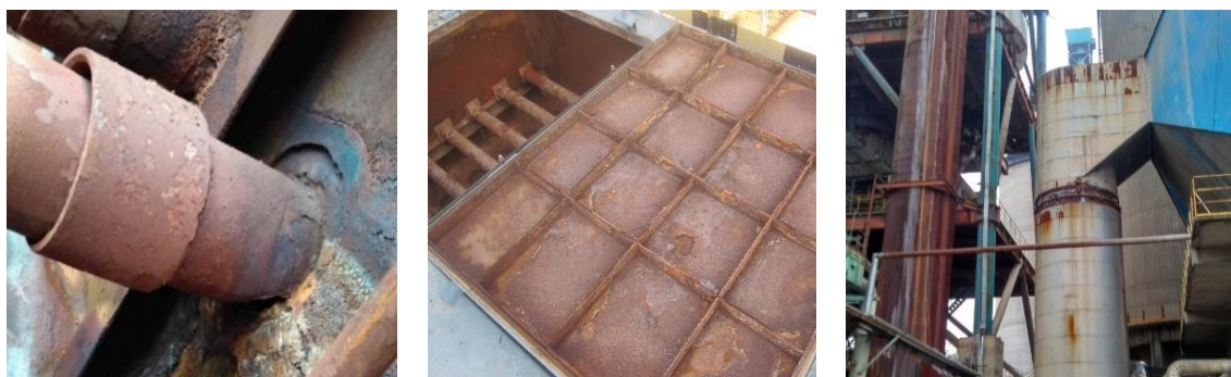
图 1 窑尾除尘器的酸腐蚀现象
